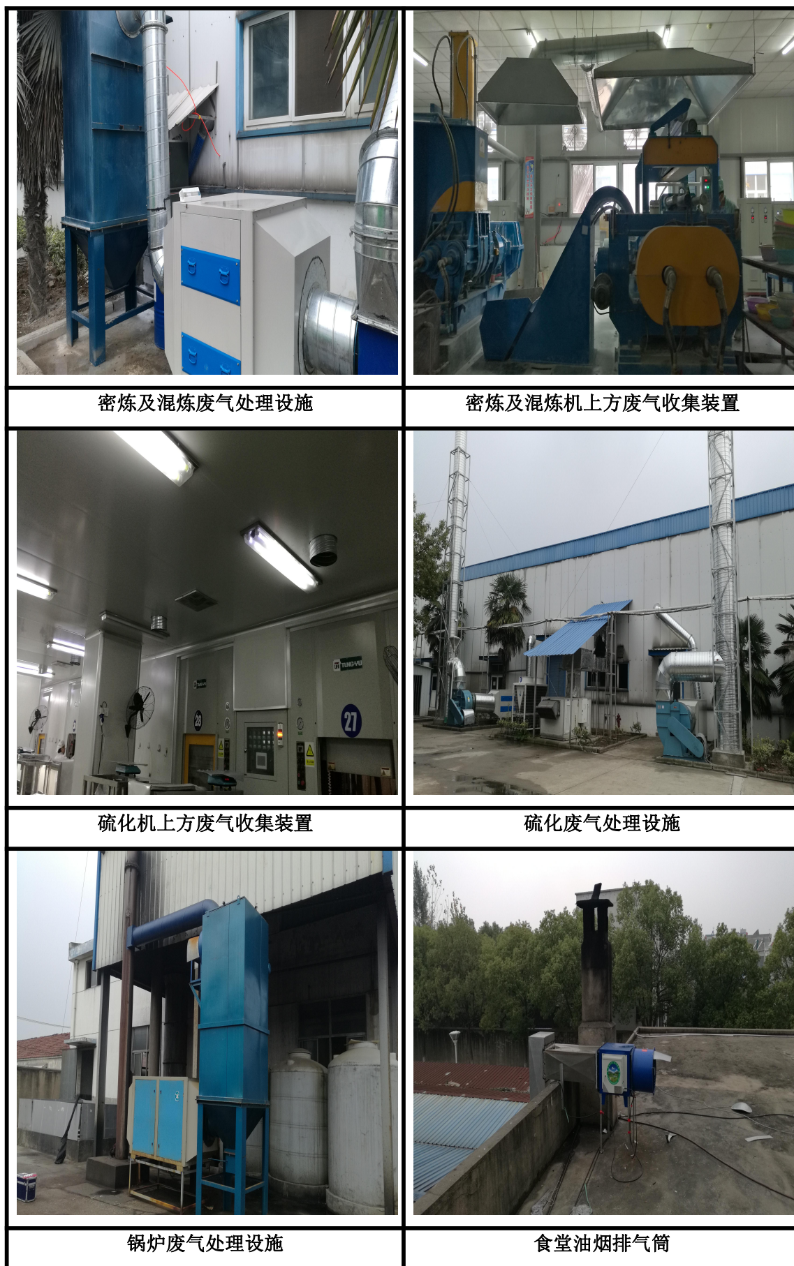
图 4.1-2 废气处理设施
