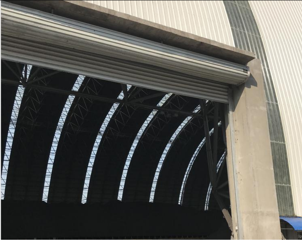
储煤棚卷闸门
