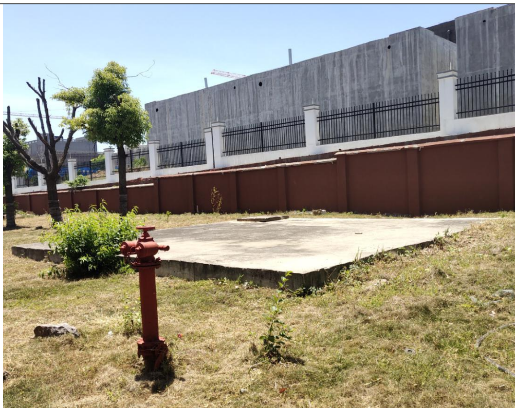
图 4：厂区污水预处理设施化粪池
