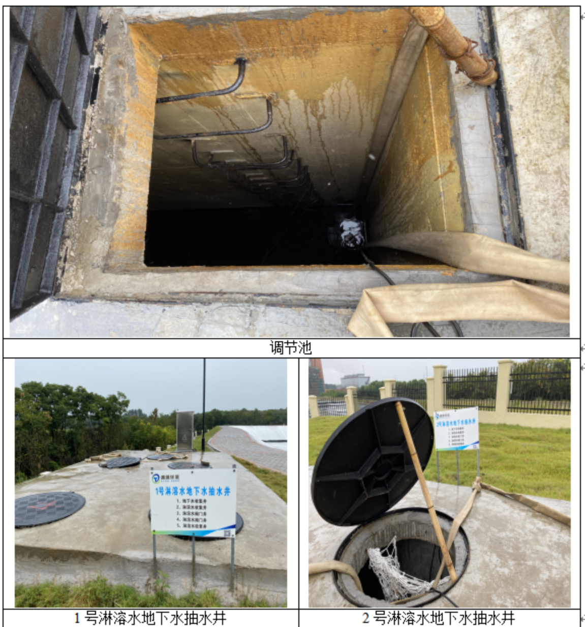
图 4.1-2 废水处理设施
