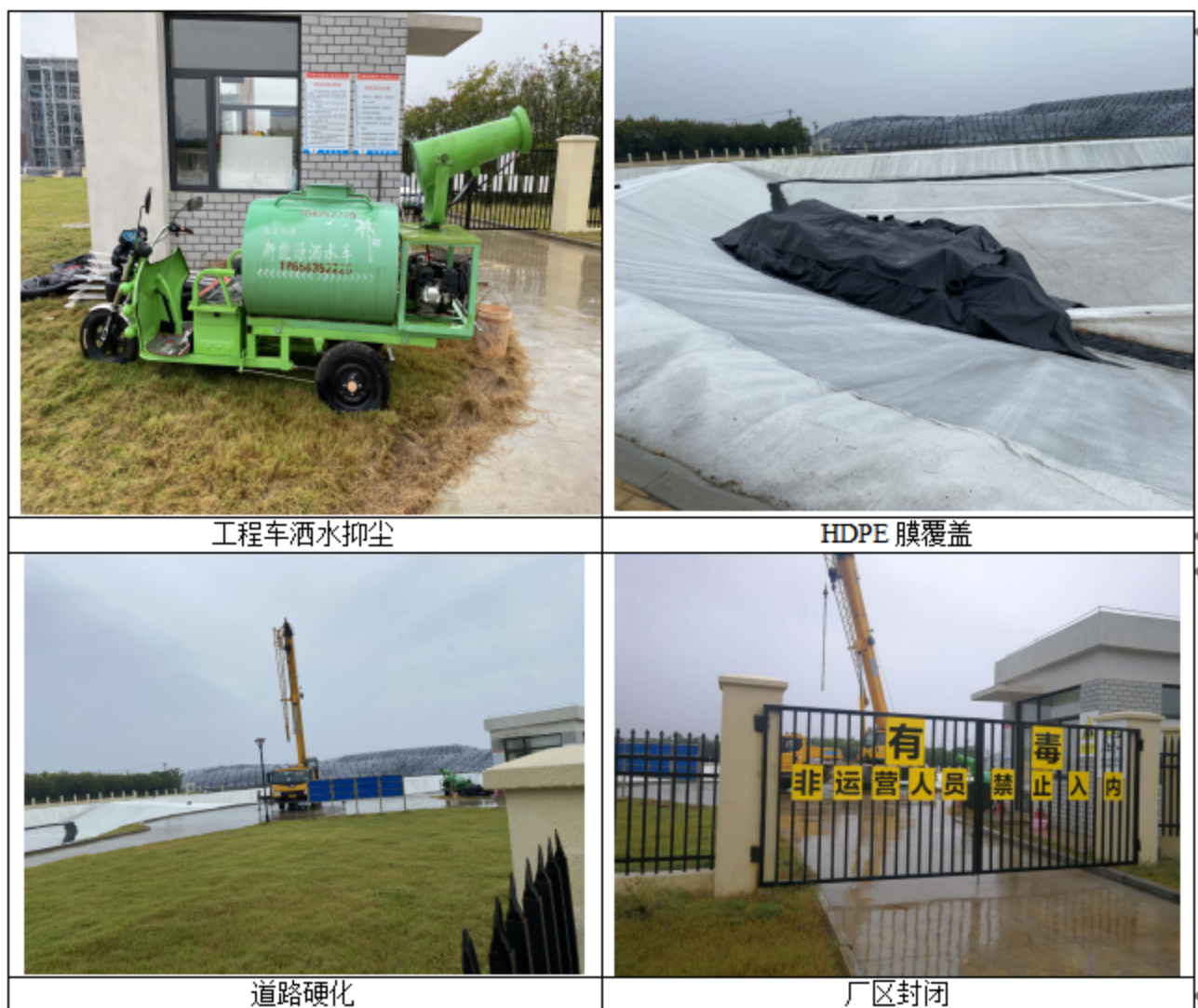
图 4.1-3 废气处理设施
