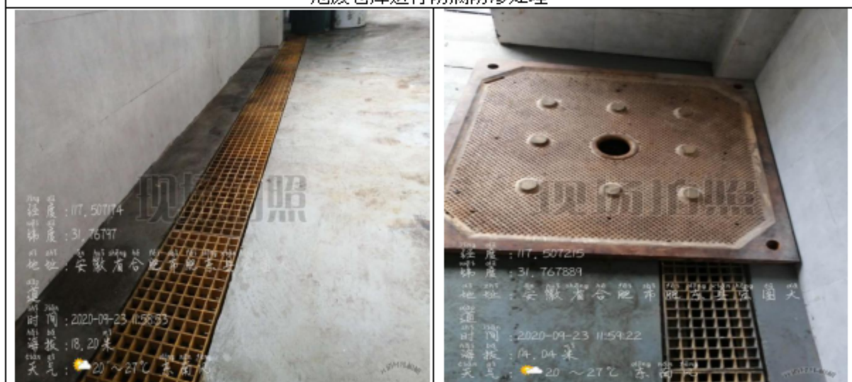
危废仓库地面设置导流槽及废液收集池
