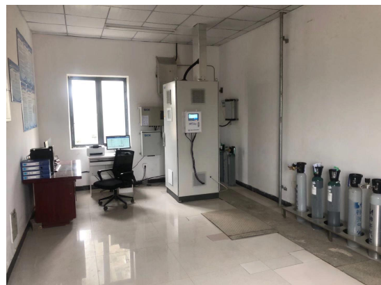
监测站房内部
