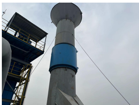
缓冲仓仓顶粉尘、石粉仓仓顶粉尘、制砂振动筛筛分粉尘、皮带输送粉尘、选粉粉尘、散装机粉尘布袋除尘器+52m 高排气筒 (DA003)
