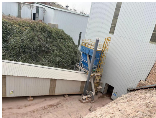
矿山土夹石预处理区破碎粉尘布袋除尘器+15m 高排气筒 (DA005)
