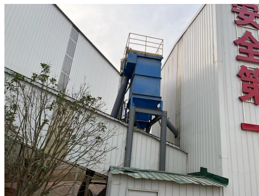
矿山土夹石预处理区一次筛分、二次筛分粉尘布袋除尘器+15m 高排气筒 (DA006)
