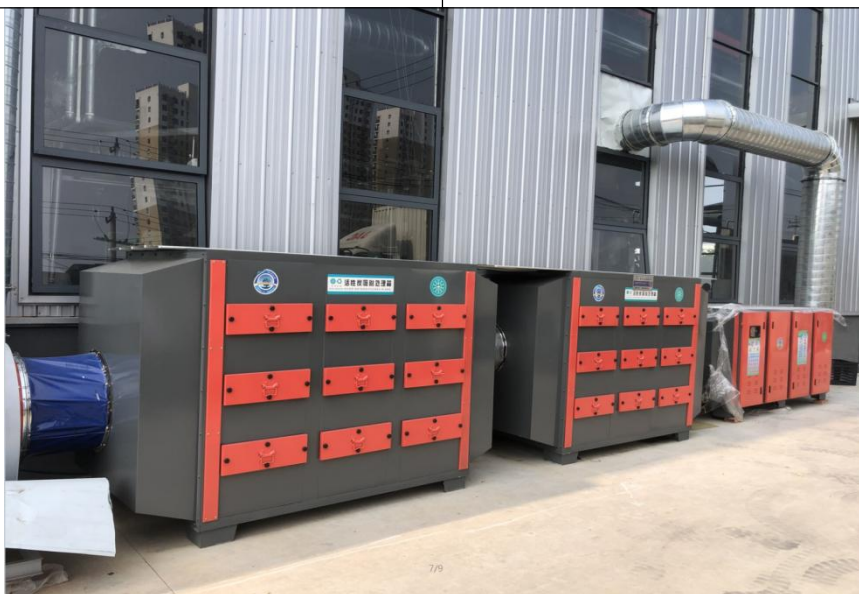
UV 光解+二级活性炭废气处理设施
