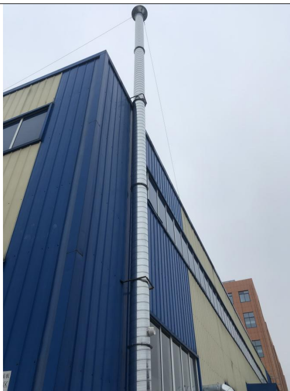
助剂仓废气排气筒
