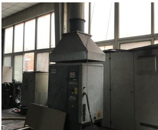
印刷车间废气收集装置
