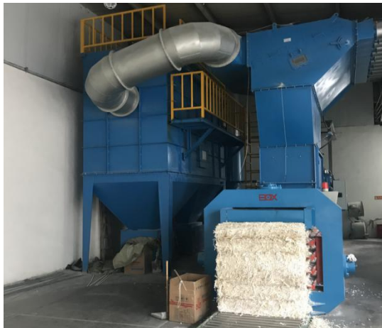
碎纸车间及其废气收集措施
