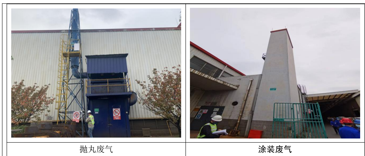
图 3-4 废气处理装置
