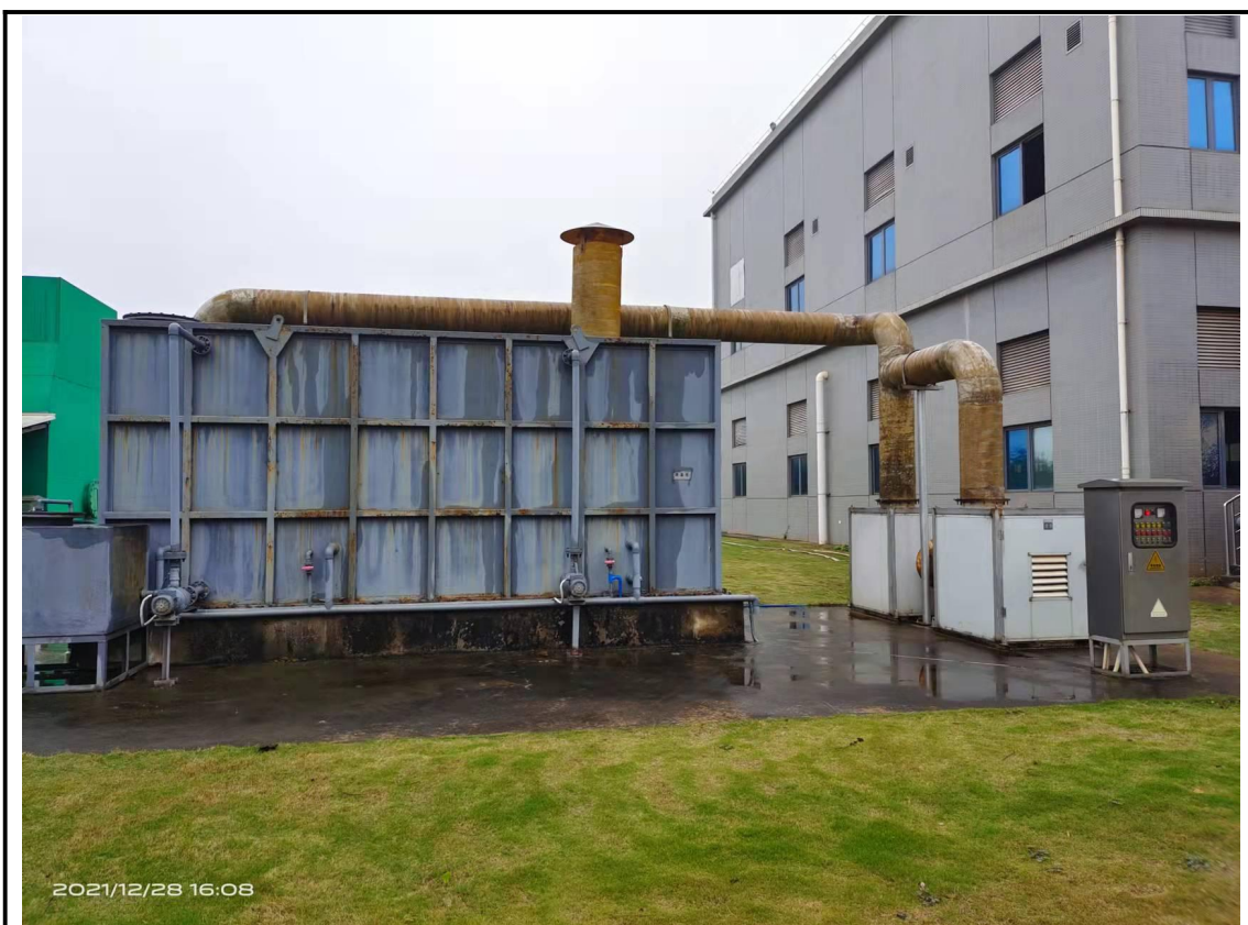
污水处理站除臭装置
