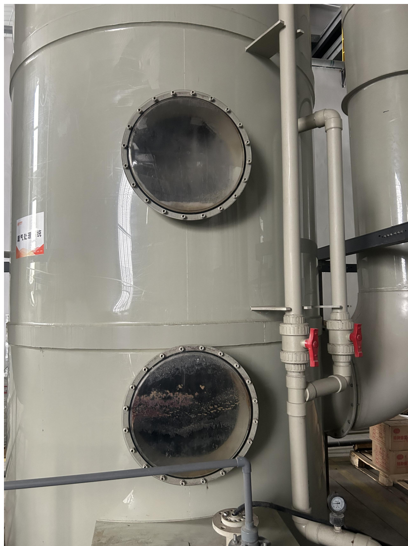
图 3-1 碱液喷淋（注液废气处理）
