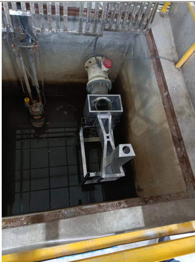
图 3-10 废水巴歇尔槽排放口
