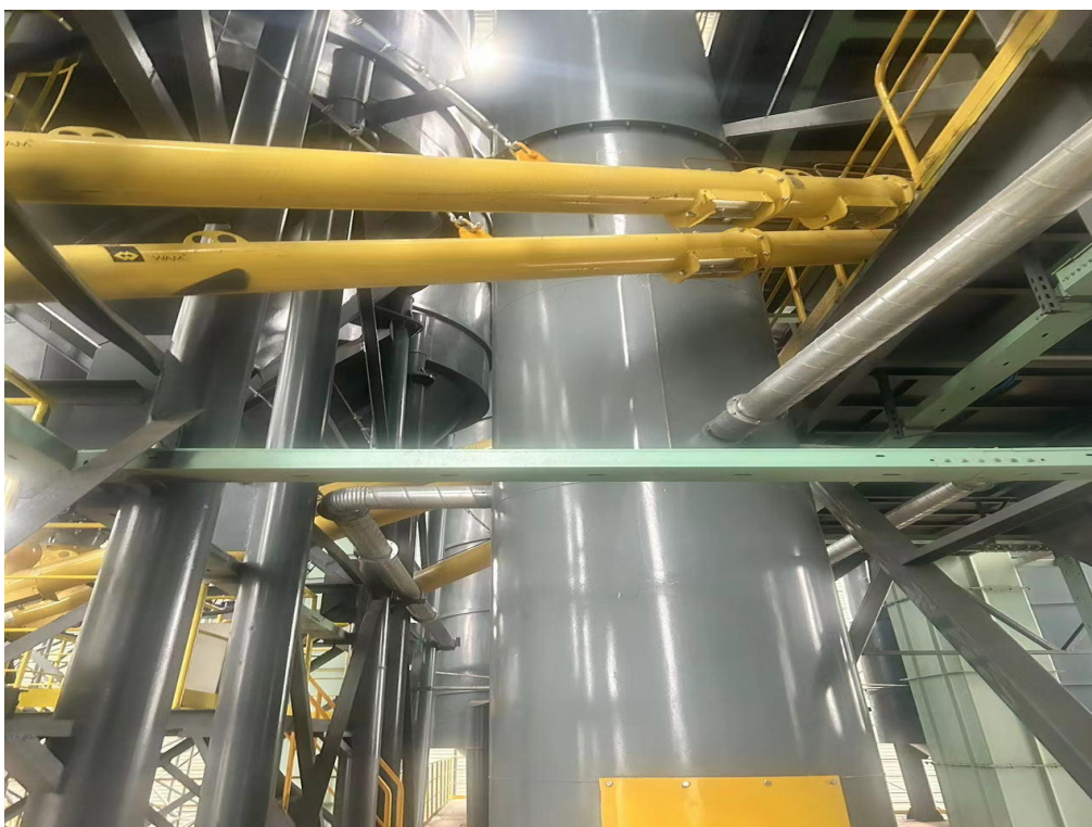
图 3-4 搅拌粉尘除尘器（DA003）
