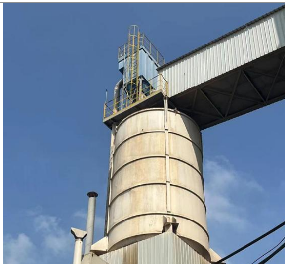
石粉库落料废气处理设施
