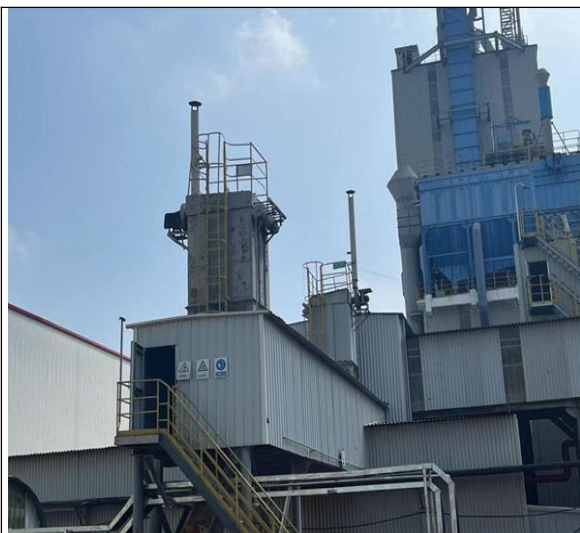
1#破碎线 1、2##石灰石转载废气处理设施
