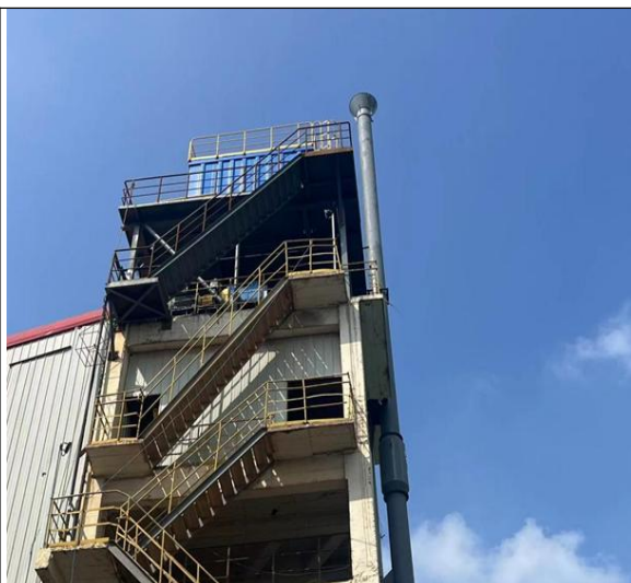
1#破碎线 3#石灰石转载废气处理设施
