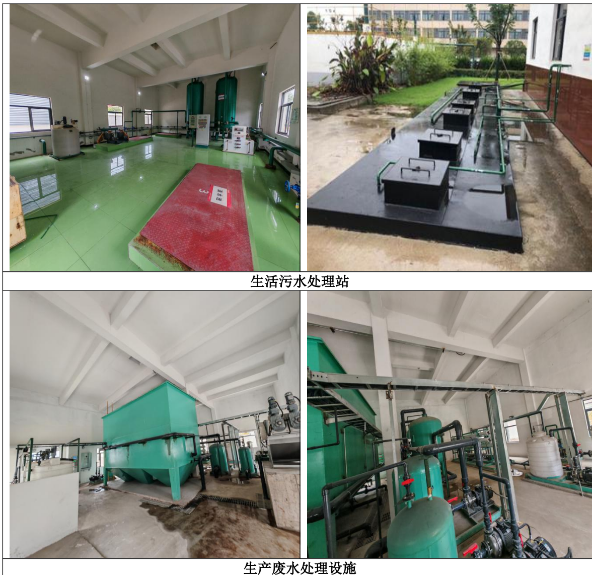
图 4.1-3 废水处理设施图片
