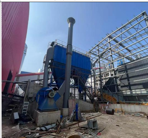
原煤破碎机废气处理设施
