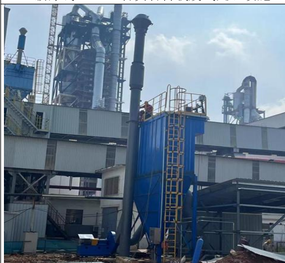
2#破碎线石灰石转载废气废气处理设施
