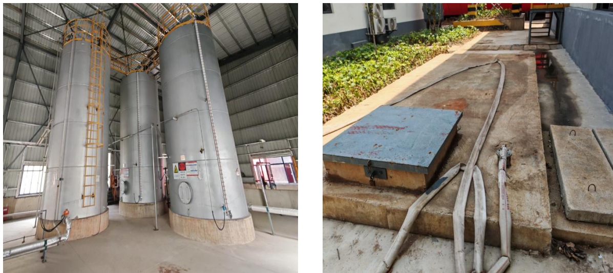
图 4.1-7 氨水罐区围堰及事故池
