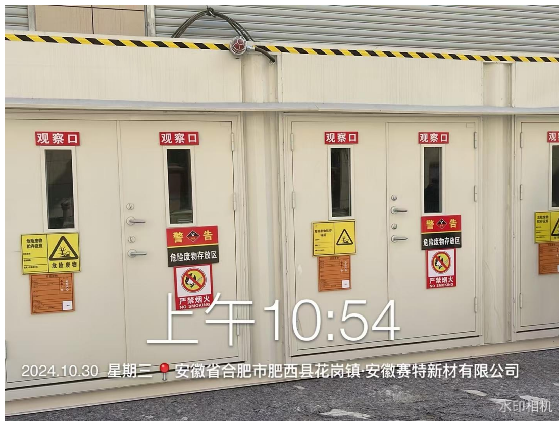
图 3-1 危废间标识牌
