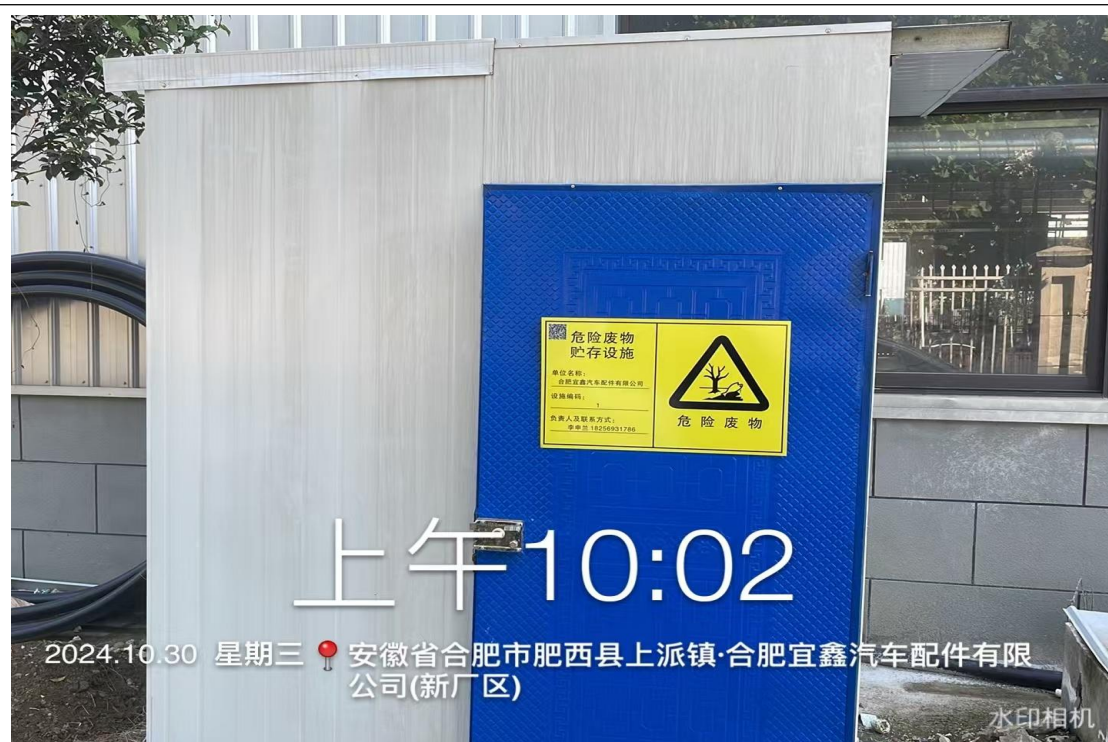
图 3-2 危废间标识牌
