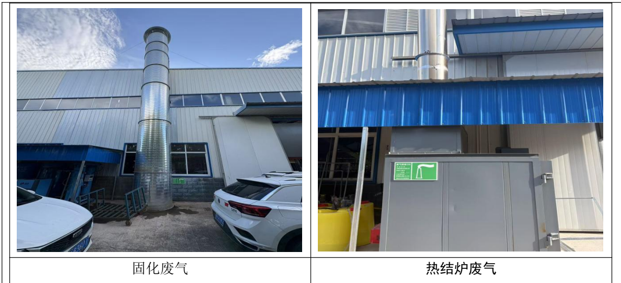
图 2-5 废气处理装置
